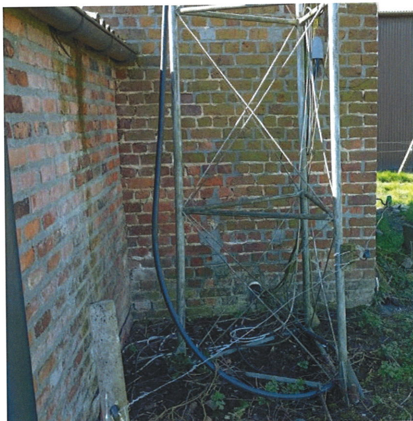
Figuur 18: Schrikdraad naast een geaarde antennemast
